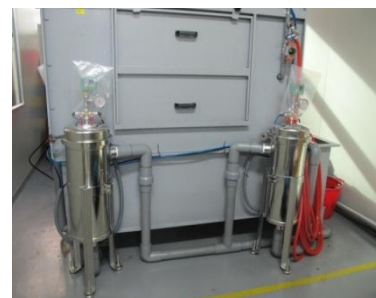
濕式集塵機設備
