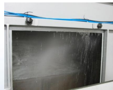
集塵機吸入艙內加裝灑水系統濕潤棉絮
