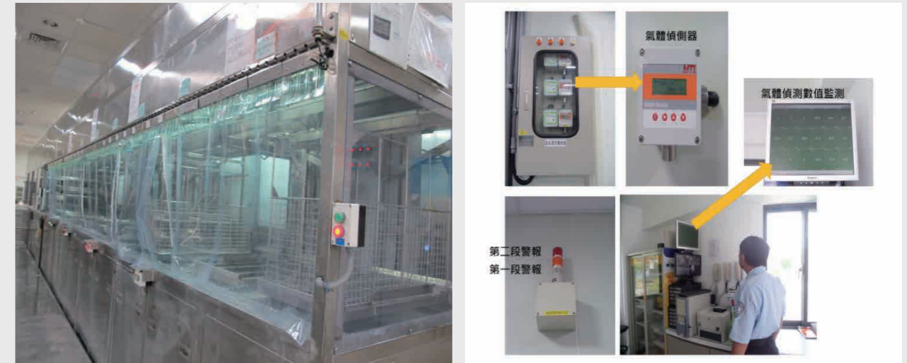
※ 洗淨機增大風管管徑和增置遮簾，降低溫度，使作業人員舒適。 ※ 增置氫氣和氧氣偵測器與監控系統，防止火災爆炸，確保人員安全。
